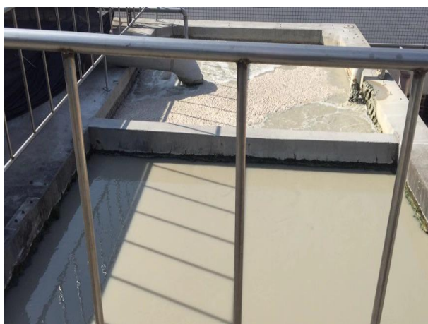
图 4-2 废水处理设施照片
