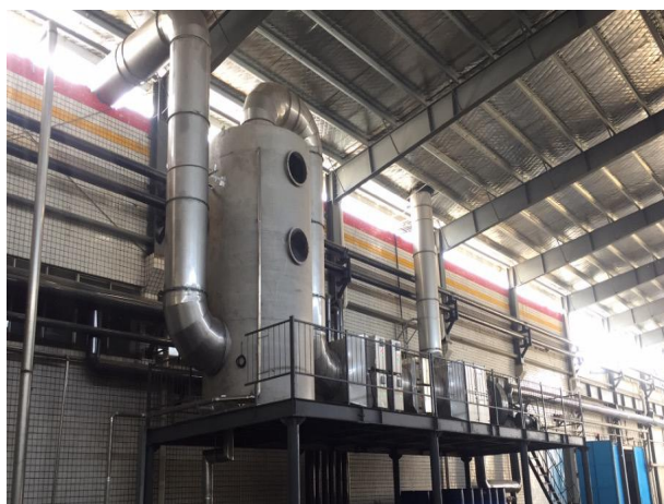
图 4-3 浆丝车间废气处理设施照片
